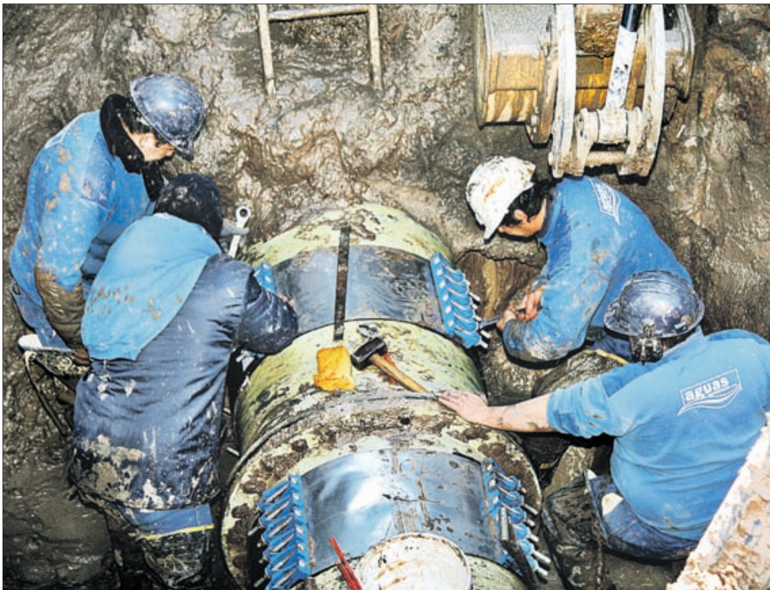
Desde ayer, operarios de Assa trabajaban para reparar el caño averiado. Se trata de una cañería de plástico reforzado con fibra de vidrio, colocada a fines de 1980, cuando se construyó la toma de agua del Riacho Santa Fe. FOTO: GUILLERMO DI SALVATORE
