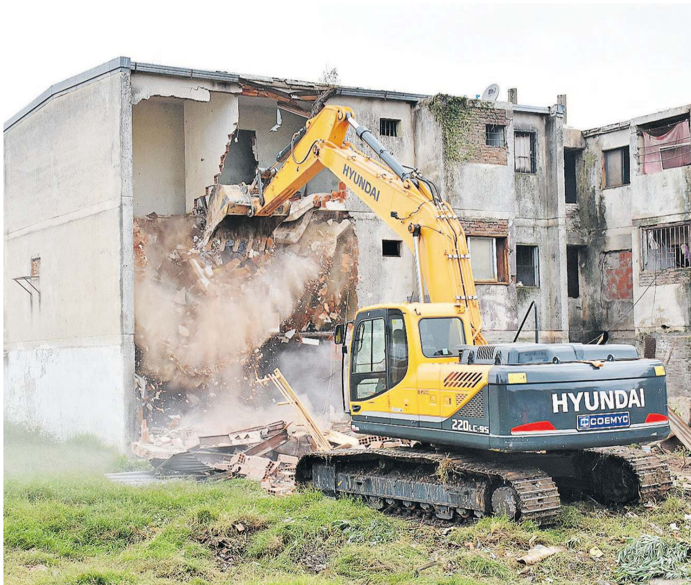
Los graves problemas estructurales de las viviendas motivaron al gobierno provincial a demoler las torres y, además, construir viviendas para reubicar las familias. FOTO: FLAVIO RAINA
